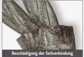
Beschädigung der Seilverbindung
